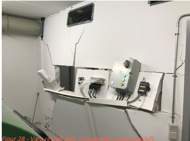
Figur 28 - Væg revnet pga. manglende erstatningsluft.
