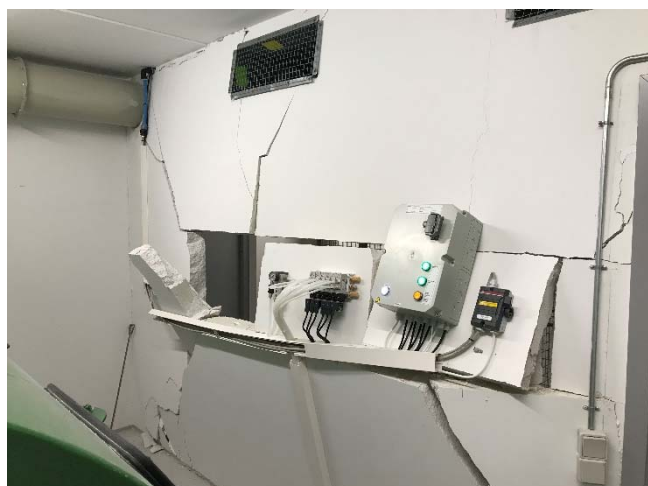
Figur 28 - Væg revnet pga. manglende erstatningsluft.
